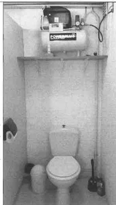
Le local "ateliers" est exigu : il a fallu chercher des astuces. Ici le compresseur pour la peinture comble une place perdue dans un lieu d'aisance voisin afin d'éviter le bruit dans l'atelier !
